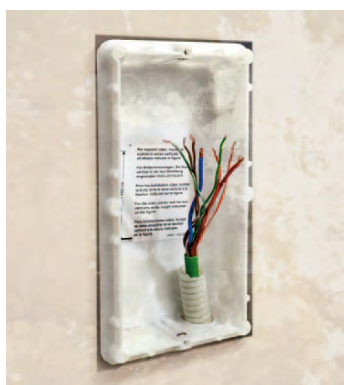
Remplacement de la platine de rue
