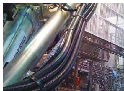
Impianti industriali Industrial plants
